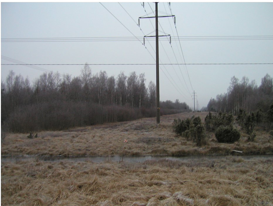
Foto 2, vaade planeeringuala läbivale 110 kV elektriõhuliinile
